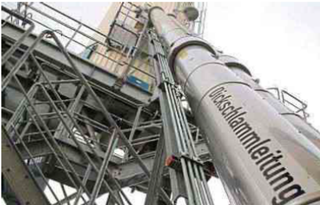
Die Zusammenarbeit wurde auf die Entsorgung von Klärschlamm, Rechengut und Sandfang ausgeweitet. FOTO: RKO
